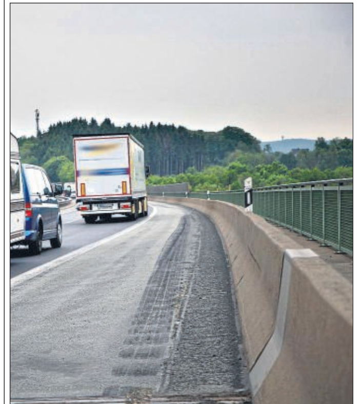
Bis Ende Juli dieses Jahres soll auf der Autobahnbrücke „Schlittenbach“ eine neue Betonschutzwand als Absturzsicherung gebaut werden. ■ Foto: Nougirgat
